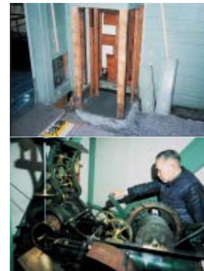
1階の床面(上)。ここに到達する直前におもりをワイヤーで巻き上げるのが和雄さんの大きな仕事だ(下・1990年当時)。(写真/札幌市)
