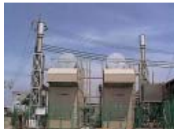
愛知工場のコージェネレーション設備
