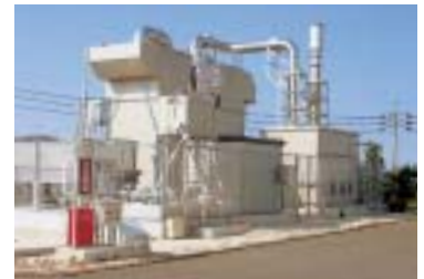
東九州工場のコージェネレーション設備
