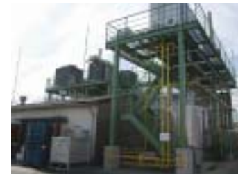
平塚工場のコージェネレーション設備
