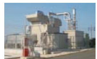
東九州工場のコージェネレーション設備
