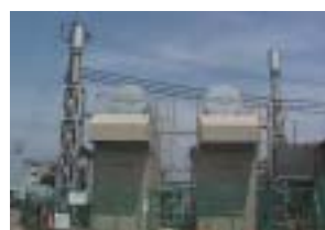
愛知工場のコージェネレーション設備
