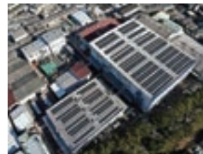
▲愛知工場 太陽光発電設備
