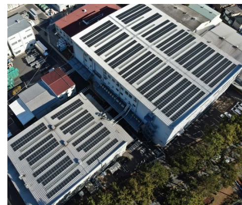
愛知工場に導入した太陽光発電設備
