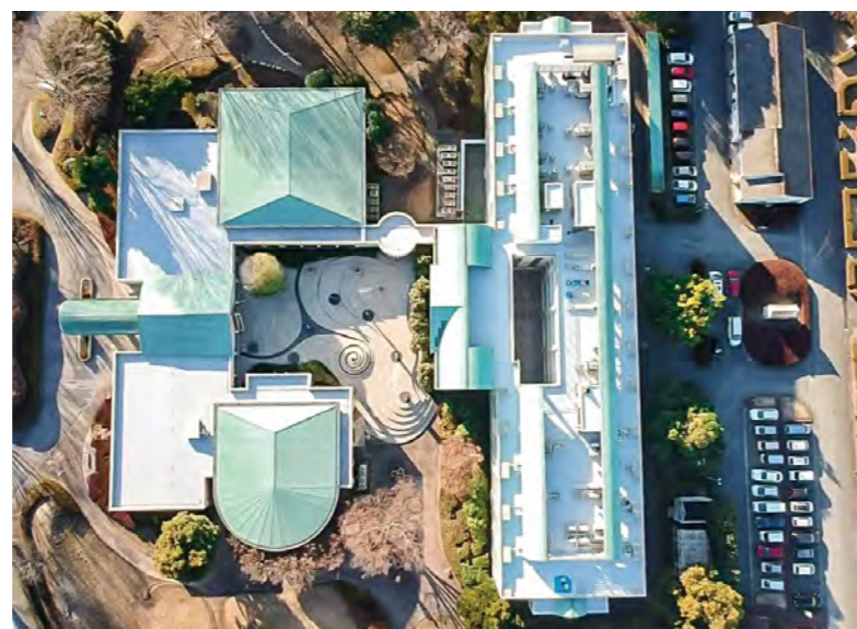
■農業研究センター管理棟他屋根・防水その他改修工事(熊本) 建築用塗膜防水材「ブルーフロンエコDX」(ウレタン圧送システム)X-1工法 /1,508㎡ 建築用塗膜防水材「ブルーフロンエコDX」(ウレタン圧送システム)X-2工法 /225.6㎡ 建設/株式会社方建設 施工/菅産業(株)
