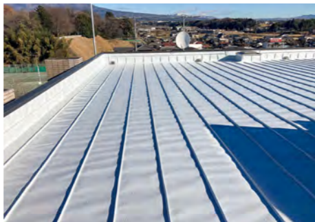
■前橋市民文化会館大胡分館シャント(群馬) 超硬化塗膜防水材「NTスプレータイプS」NY-SS20S 工法/260㎡ 施工/㈱テッシン
