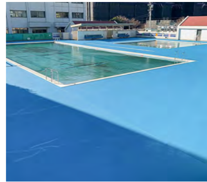
■三好丘小学校プールサイド塗装工事(愛知) カラー舗装材「ユータックテクノ遮熱ONE」ローラー防滑工法/667㎡ 建設/加藤建設株式会社 施工/株式会社
