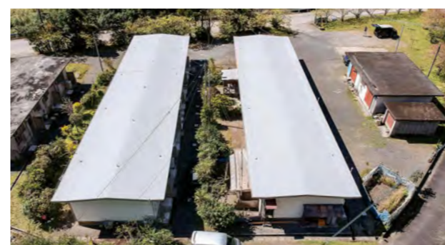
■令和2年度市営住宅外壁落下防止等改修工事(石原住宅 1.2号棟)(鹿児島) 超硬化塗膜防水材「NTスプレータイプS」NK-SS30S 工法(機械的固定工法)/214.6㎡ 建設/有愛建工業 施工/有村防水
