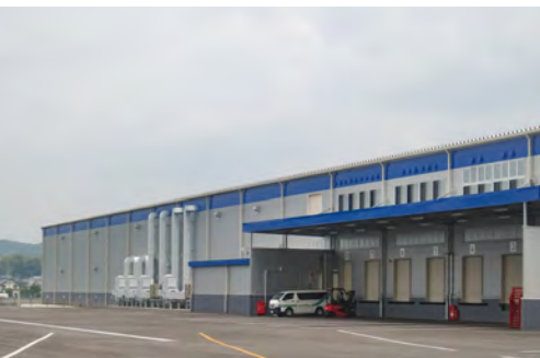
■某物流倉庫新築工事(岡山) 塗り床材「ユータックE-30N」流し展べ工法/15,000㎡ 施工/株式会社
