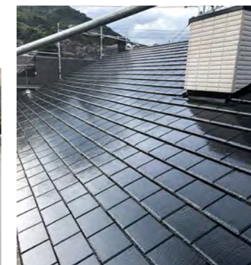
■某住宅(長崎) 建築外装用塗料「エポラオールプライマー+ リリーフNADシリコン」 施工/ミリッペ
