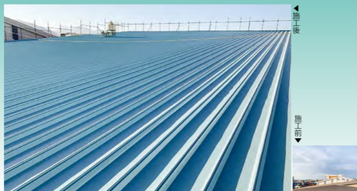
■大分市某倉庫屋根改修工事(大分) エポキシ樹脂下塗り塗料「エポラオールプライマー」 建築屋根用遮熱塗料「パラサーモシリコン」(ライトブルー)/1,800㎡ 建設・施工/梶有永塗装
