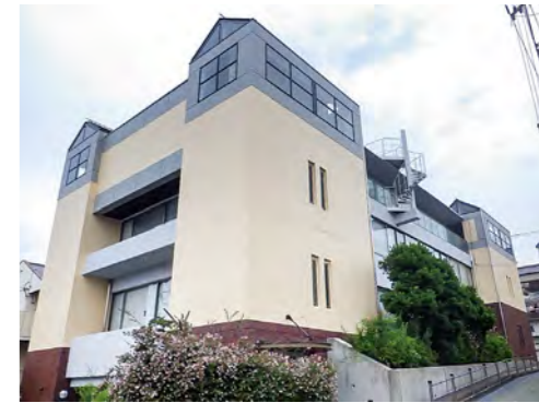
■KY神戸ビル建物改修工事(兵庫) 高弾性外壁防水塗料「ハイブルーフ」大波工法ハイブルーフ上塗WF仕上げ/350㎡ 施工/株式会社
