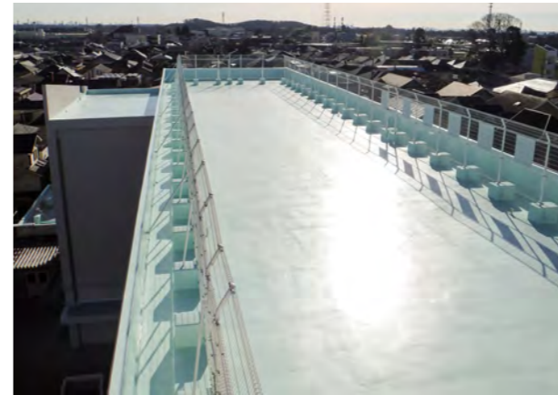
■府中市立新町小学校校舎外壁及び屋上防水等維持改修工事(東京) 建築外装用塗料「シルビアサーフ+シルビアWF#400」/4,700㎡ 建築用塗膜防水材「ブルーフロンバリュー」X-1工法/2,000㎡ 建築用塗膜防水材「ブルーフロンバリュー」X-2工法/220㎡ 設計/府中市役所 元請会社/信和建設(株)
