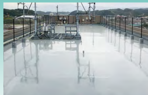
■ナガトモビル人吉(熊本) 建築用塗膜防水材「ブルーフロンバリュー」X-1工法/400㎡ 施工/㈱森田塗装店
