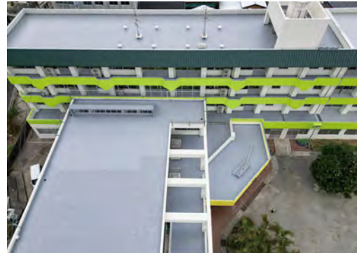
■某小学校屋上防水(鹿児島) 超速硬化ウレタ・ウレタン系塗膜防水材スプレーシステム「NTスプレータイプS」NK工法(機械的固定工法)/1,000㎡ 施工/㈱有村防水
