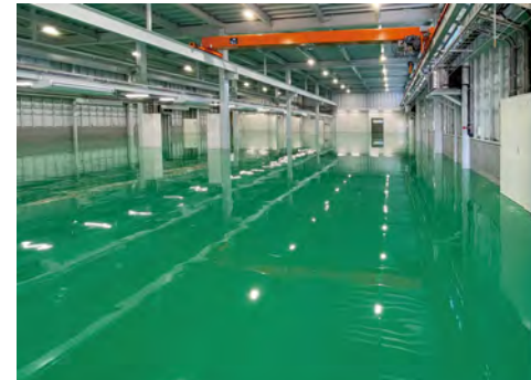
■某化学工場床新築(富山) 塗り床材「ユータックE-30N」樹脂モルタル流し展べ工法/1,500㎡ 施工/株式会社愛知レジン
