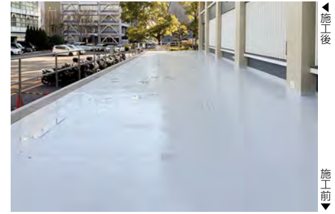
■広島県庁舎本館厨房下屋改修その他工事(広島) 建築用塗膜防水材「ブルーフロンエコHG」PX-HG30G工法/681㎡ 施工/丸福建材工業(株)
