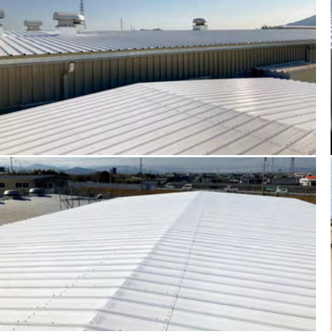
■某工場屋根改修工事(徳島) 屋根用遮熱塗料「パラサーモフッ素」/3,000㎡ 施工/矢野塗装
