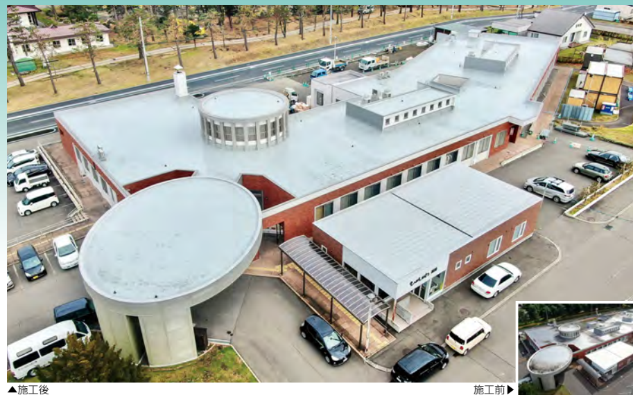
■東川町立診療所(北海道) 超速硬化ウレタ・ウレタン系塗膜防水材スプレーシステム「NTスプレータイプS」NY-SS30G工法/2,077㎡ 建設/株式会社高組 施工/株式会社アイ・ディー・エフ
