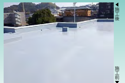
■長与町ふれあいセンター屋上防水工事(長崎) 建築用塗膜防水材「ブルーフロンバリュー」X-1工法/900㎡ 施工/㈱明光ビルドスペース
