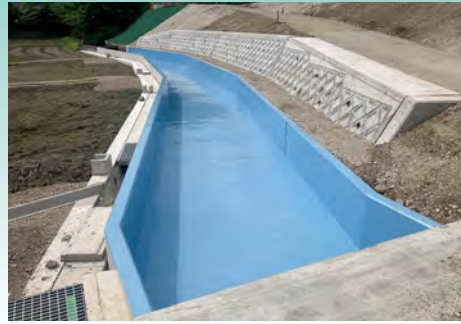
■亀岡市用水路(京都) 上水道貯水槽内面保護塗料「ガードブルーF」コーティング工法/190㎡ 施工/日本システム(株)
