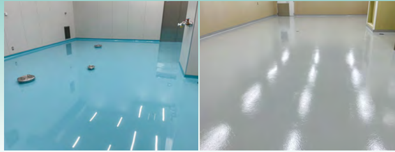
■某工場新築工事(埼玉) 塗り床材「ユータックE-30N」ハード流し展べ工法/430㎡ 塗り床材「ユータックE-40」コーティング工法/525㎡ 施工/俣井上建築
