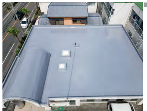
■某指定避難所(鹿児島) 建築用塗膜防水材「ブルーフロンアーク」仮防水仕様/500㎡ 建築用塗膜防水材「ブルーフロンエコHG」[ブルーフロンエコHG MID]密着工法/500㎡ 施工/㈱有村防水
