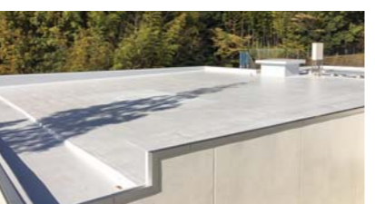
■玖波小学校改築工事(建築主体工事)(広島) 超硬化塗膜防水材(スプレータイプ)「NTスプレータイプS」NKD-SS30S工法/1,124.8㎡ 超硬化塗膜防水材(スプレータイプ)「NTスプレータイプS」NM-SS30S工法/799.2㎡ 超硬化塗膜防水材(スプレータイプ)「NTスプレータイプS」NMT-SS20S工法/229.4㎡ 建設/㈱増岡組 施工/㈱フジミクレ
