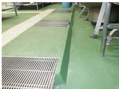
■医療法人社団高仁会厨房改修工事(佐賀) 塗り床材「ユータックコンプリート」CPM工法/220㎡ 建設/㈱ニシイ 施工/㈱駿河コーポレーション
