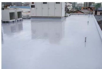
■大昭和紙工業㈱王子印刷工場屋上改修工事(東京) 建築用塗膜防水材「ブルーフロンバリュー」X-2工法、建築用塗膜防水材用上塗り遮熱塗料「ブルーフロンGR」トップ遮熱」仕上げ/300㎡ 施工/協和創建㈱
