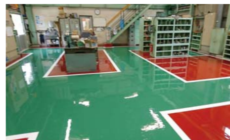
■松本市某工場床改修工事(三重) 塗り床材「ユータックE-30N」流し展べ工法/200㎡ 施工/ライニング技術工業㈱
