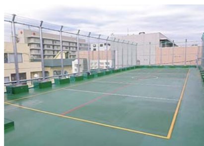
■某小学校屋上防水改修工事(東京) 建築用塗膜防水材「ブルーフロン」スポーツ床防水工法/150㎡
