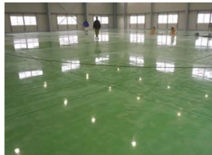
■小岩運輸㈱(岩手) 塗り床材「ユータックE-30N0 ーラー用」(施工中)/1,300㎡ 施工/(合)山口塗装店
